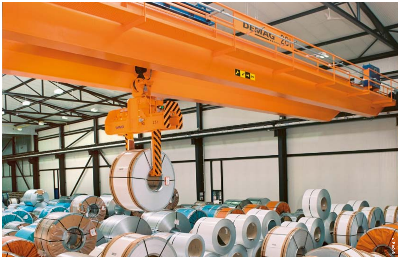
Feinfühlinger Transport von Bandstahl in einem Coil-Lager
